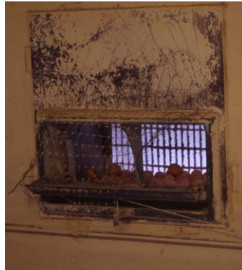
Abb. 82: Durch ein defektes Netz gelangen Hennen in das Zuluftelement und praktizieren hier die Eiablage.
