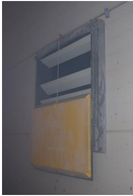
Abb. 81: Die fehlende Lamelle in der Zuluftöffnung sollte schnellstmöglich ersetzt werden.
