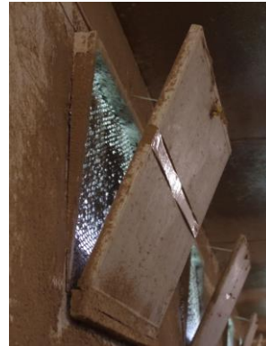
Abb. 83: Das Windnetz in der Zuluftklappe sollte gereinigt werden.
